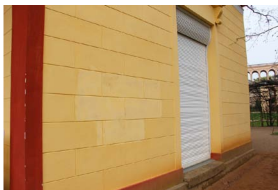
Schäden Farbe Außenwände Pomonatempel © SPSP, FVP
