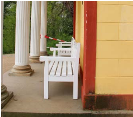
Schäden Außenwände Pomonatempel (c) SPSP, FVP
