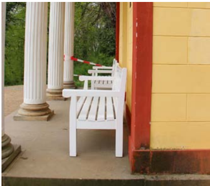
Schäden Außenwände Pomonatempel (c) SPSP, FVP
