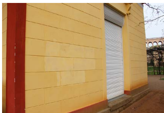
Schäden Farbe Außenwände Pomonatempel © SPSP, FVP
