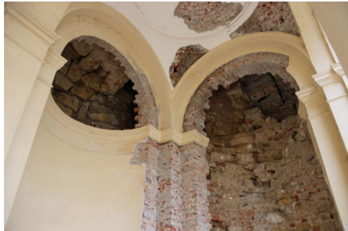
Schäden an der Eingangshalle des Belvedere © SPSG, Foto: Förderverein Pfingstberg
